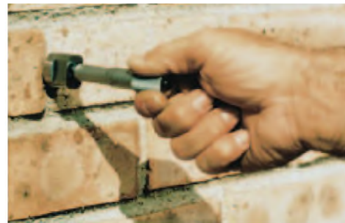
Midiendo Micrómetro de aguja midiendo la profundidad de una penetración de clavo en una junta de argamasa
