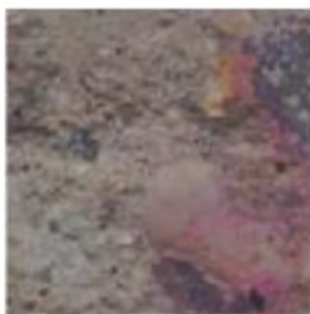
Hormigón no tratado.
